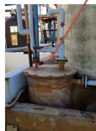
Fig. Dettaglio sistema di abbattimento fumi H 2 SO 4
